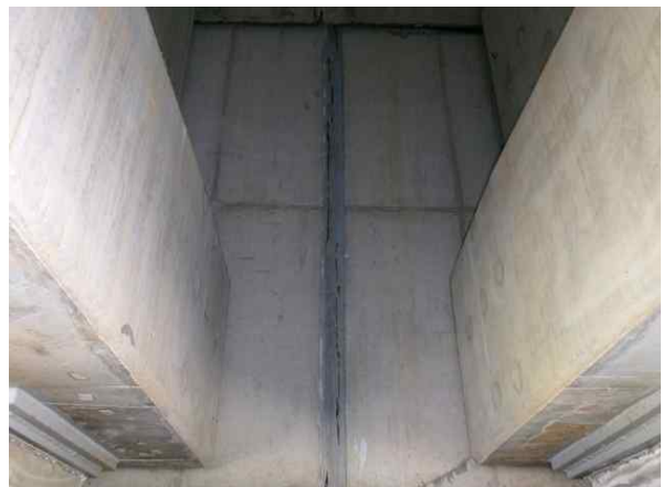
A2 실란트 파손
