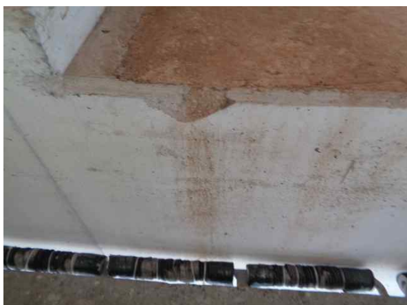
P4 코핑부 파손(0.2×0.1)
