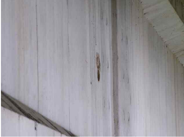
S6-G1 인양홀 파손(0.3×0.3)
