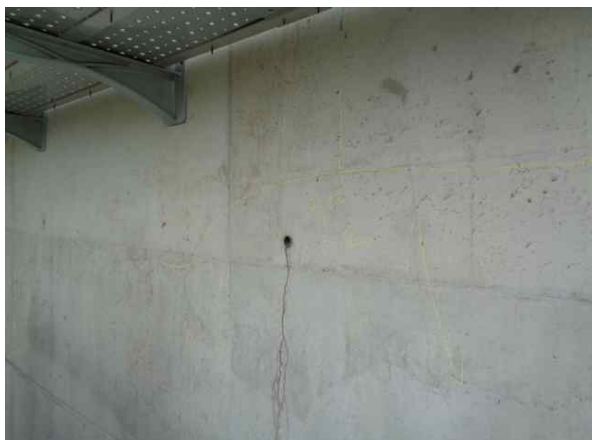
P1 코평부 균열(Cw=0.3mm미만)
