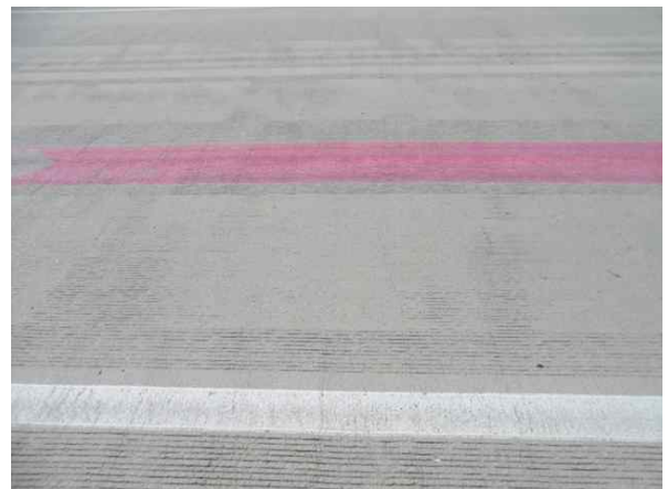
S2 포장 망상균열(35.0×3.0)
