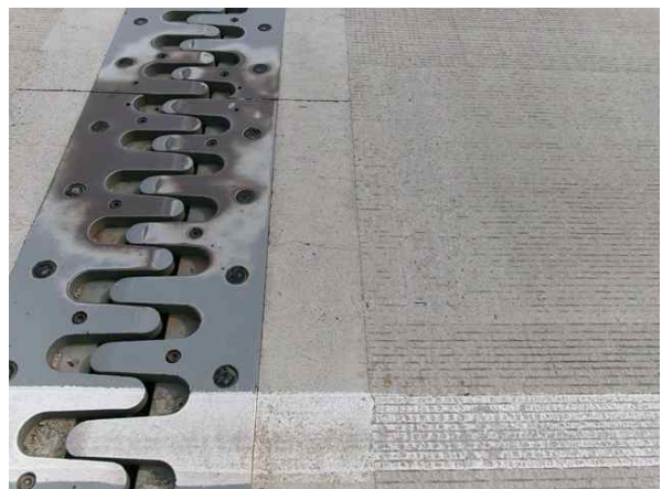
P6 후타재 균열(Cw=0.3mm미만)
