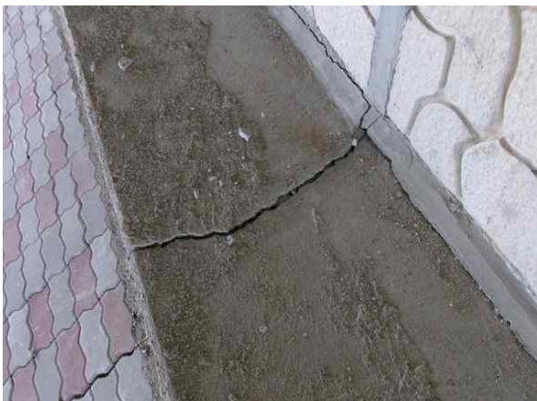
A2 법면 물탈 파손(0.1×1.5)
