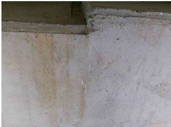
P1 코핑부 균열 (Cw=0.3mm미만)
