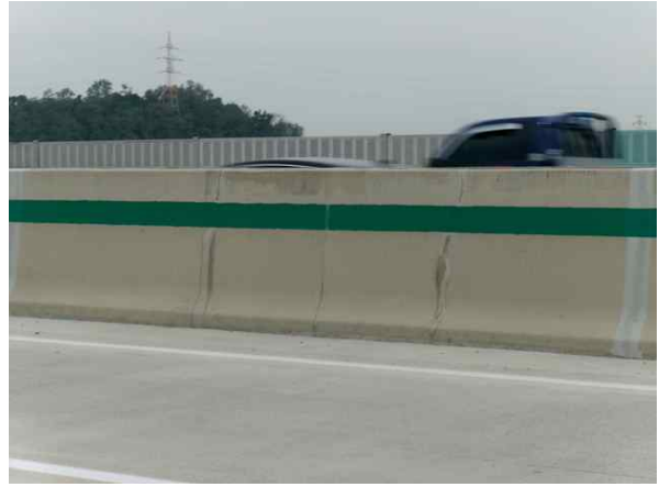
S6 중앙분리대 균열부 백태(0.1×1.0×8EA)
