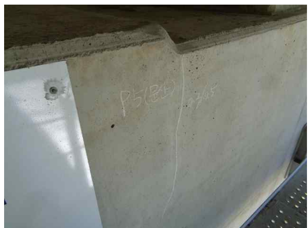
P5 코핑부 균열 (Cw=0.3mm미만)
