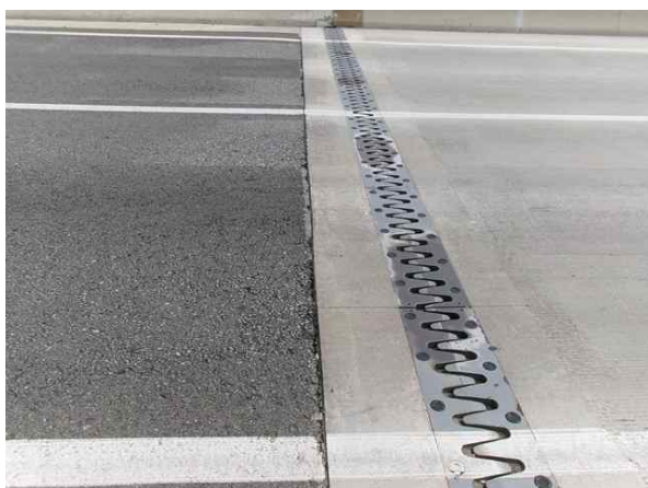
A2 후타재 균열(Cw=0.3mm미만)
