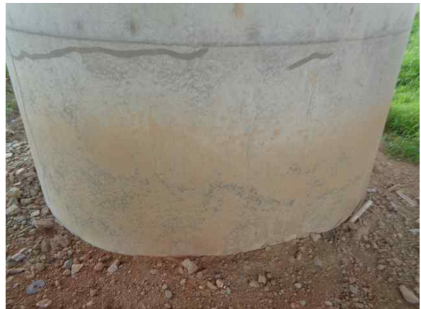
P5 기둥부 망상균열(2.5×1.0)
