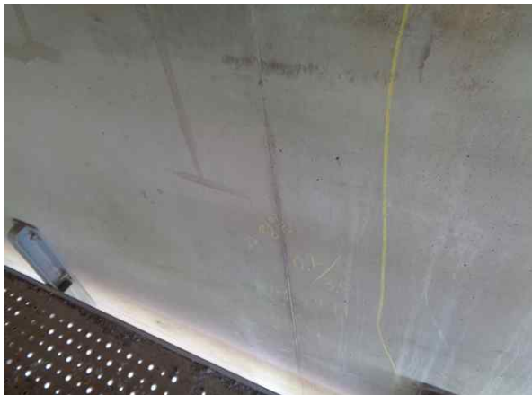
P1 코핑부 균열(Cw=0.3mm미만)
